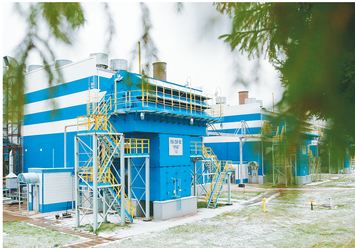
Компрессорная станция «Игринская».
