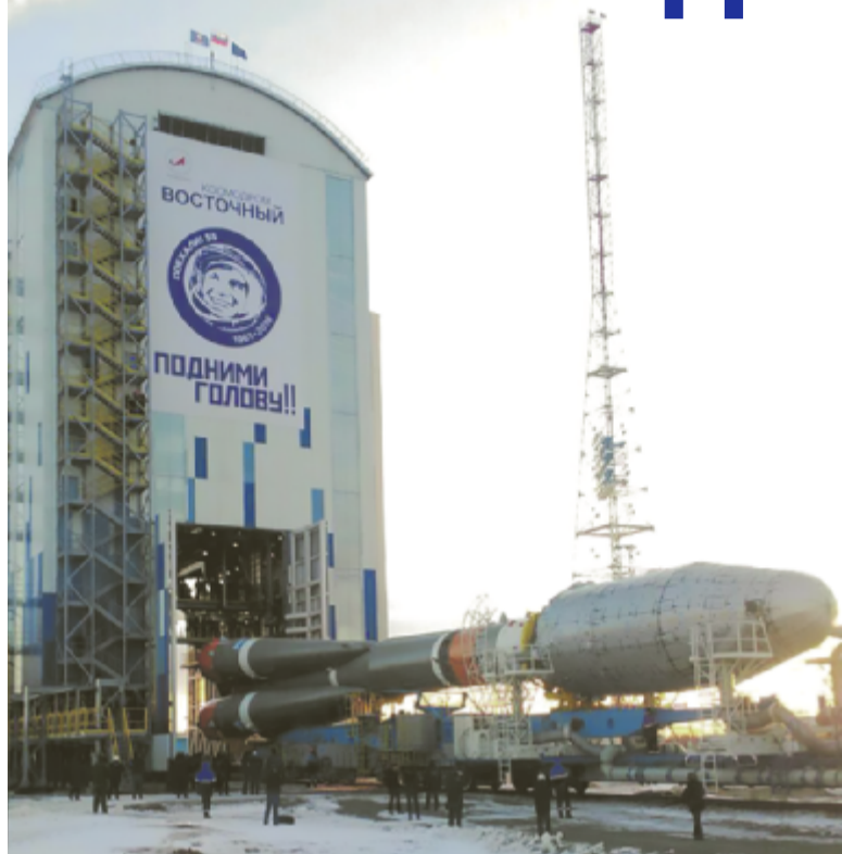
Фото предоставлено ООО «Камаэлектромонтаж». Космодром «Восточный», Амурская область.
