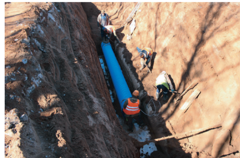
Глубина траншеи составляет 5 метров. Новую пластиковую трубу ведут рядом со старой по двум причинам. Во-первых, очень близко проходит стратегический водовод большого диаметра – 700 мм. Если случайно его задеть, то можно весь город оставить без воды. А во-вторых, от прежней трубы остался практически только низ, верх просто рассыпался от времени
