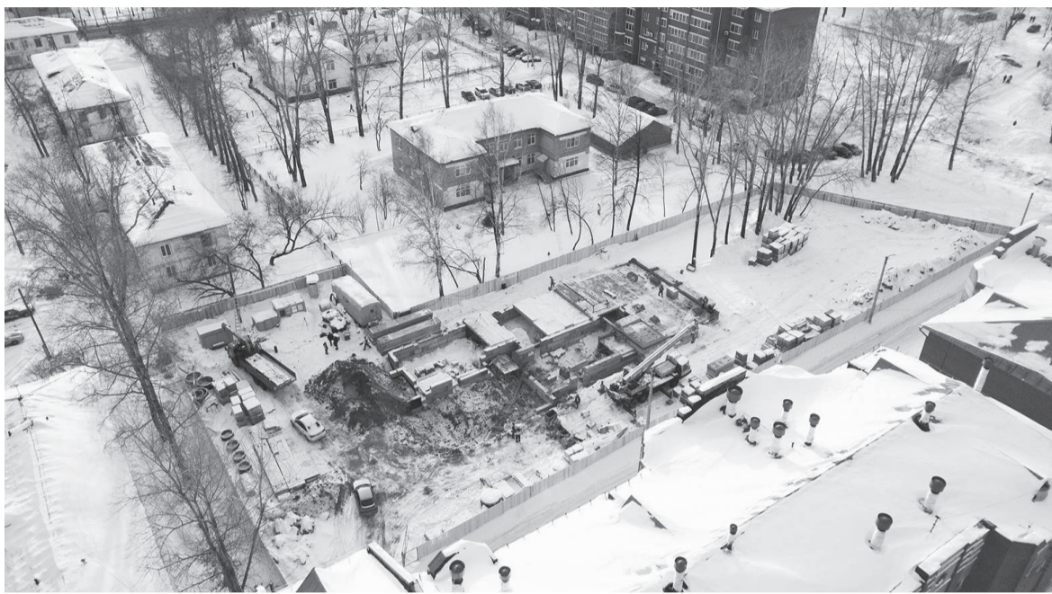
19 февраля, вид сверху на строительную площадку. По информации жителей соседних домов, стройка идёт «ударными темпами» по 10–14 часов, в том числе и в выходные
