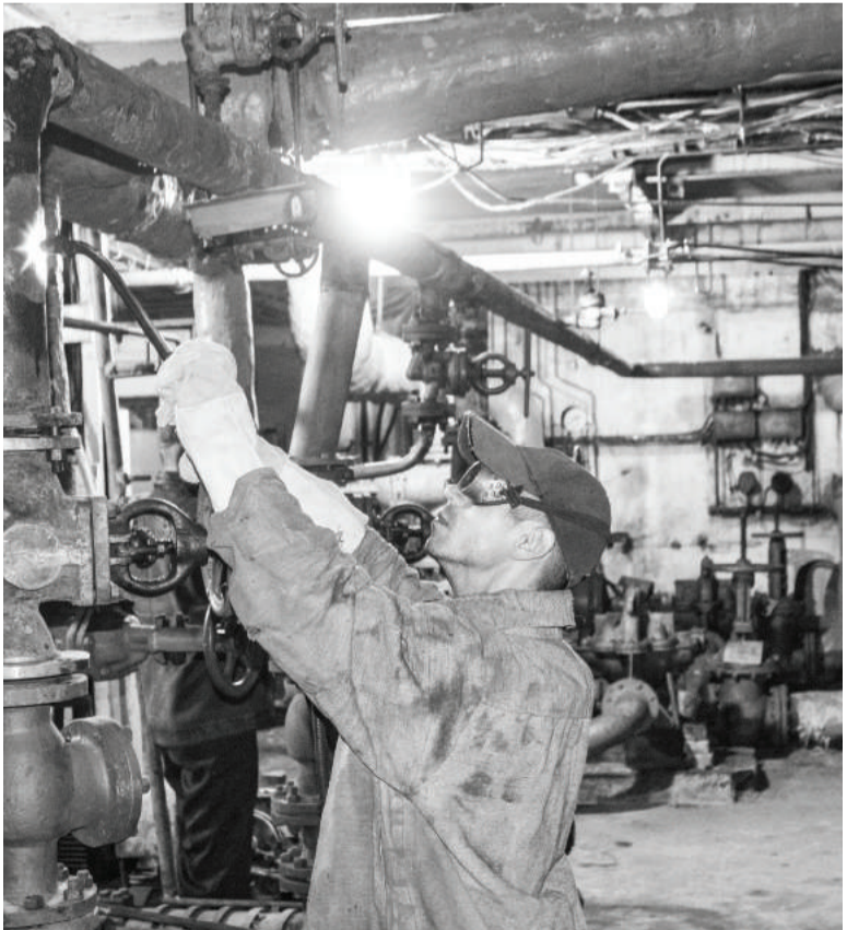
Жёсткие сроки определены специалистам предприятия «РТК»: необходимо за 2 месяца подготовить котельную ЖБИК к отопительному сезону
